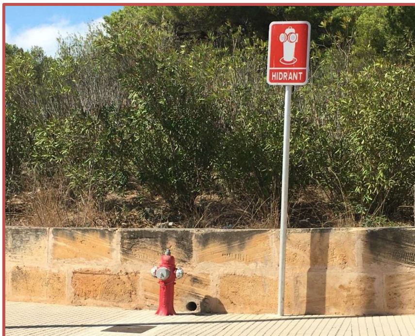
Imatge 20. Hidrant localitzat a l'interior d'un nucli de població. Font: Medi XXI – GSA.
