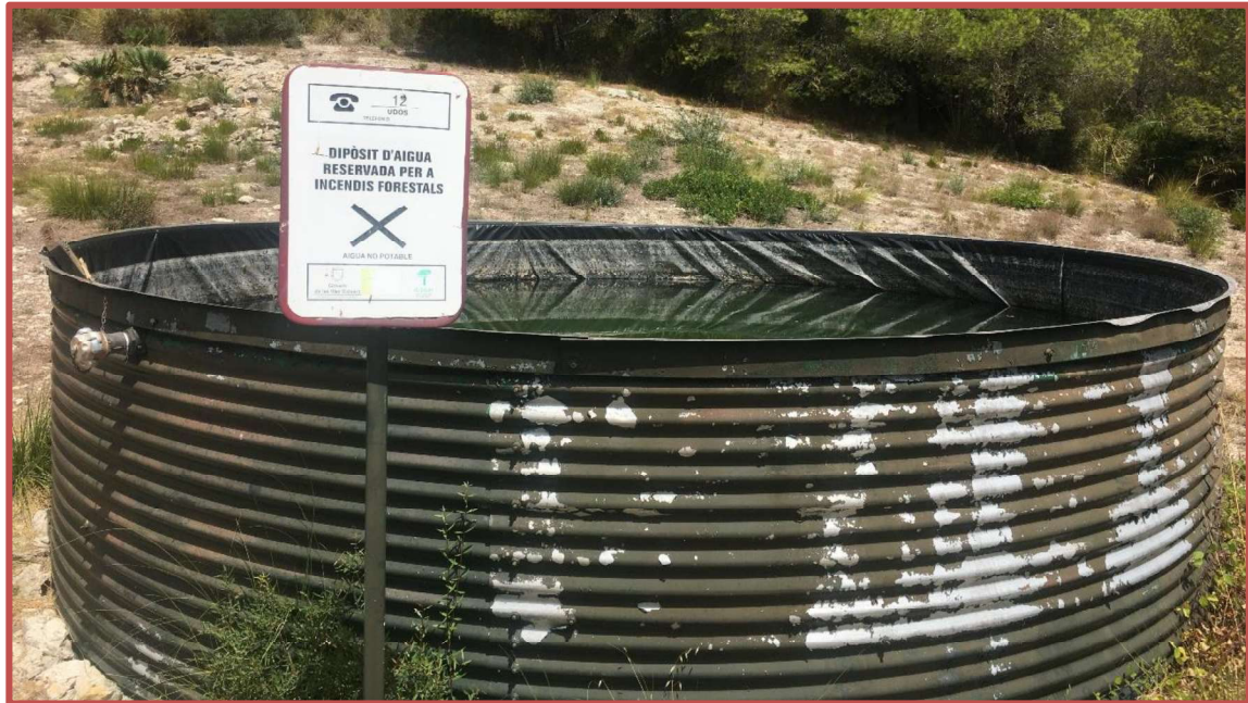
Imatge 19. Dipòsit d'aigua per l'extinció d'incendis forestals. Font: Medi XXI – GSA.
